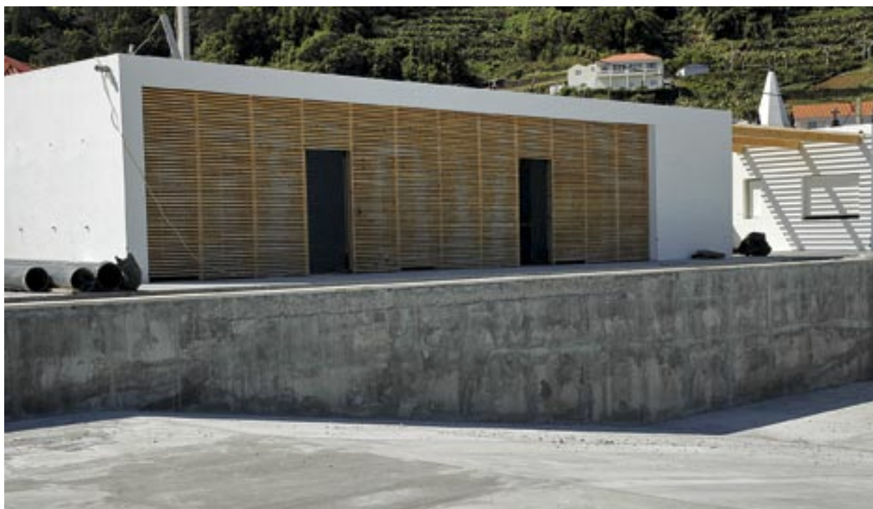
CONSTRUÇÃO DA PISCINA MUNICIPAL DE SANTA CRUZ, FREGUESIA DAS RIBEIRAS: FINALIZAÇÃO DA OBRA DE CONSTRUÇÃO CIVIL PREVISTA PARA A SEGUNDA QUINZENA DE MAIO, A QUE SE SEGUE CERCA DE UM MÊS DE ACABAMENTOS.
