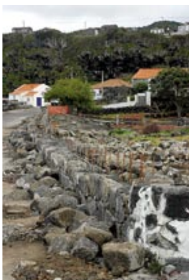
RECONSTRUÇÃO DE MUROS NO CALHAU, FREGUESIA DA PIEDADE: EM FASE DE ACABAMENTOS.
