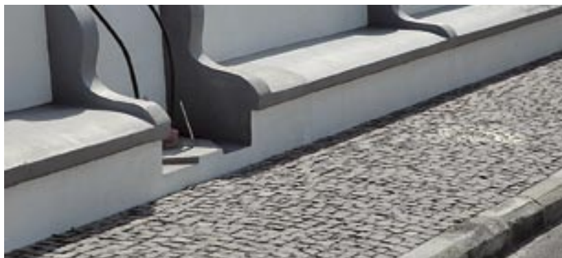
PAVIMENTAÇÃO DOS PASSEIOS DO LARGO DE SANTA BÁRBARA, FREGUESIA DAS RIBEIRAS: EM CONCLUSÃO.
