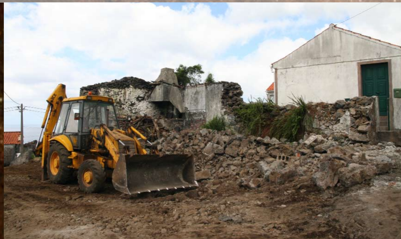
Aquisição de moradia para demolição e alargamento da Canada da Cruz, na Almagreira
