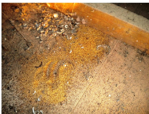
Figura 5: Produção orgânica de térmita de madeira seca em falsa na localidade de Santa Cruz das Ribeiras – indício inequívoco da presença de uma espécie de térmita de madeira seca.
